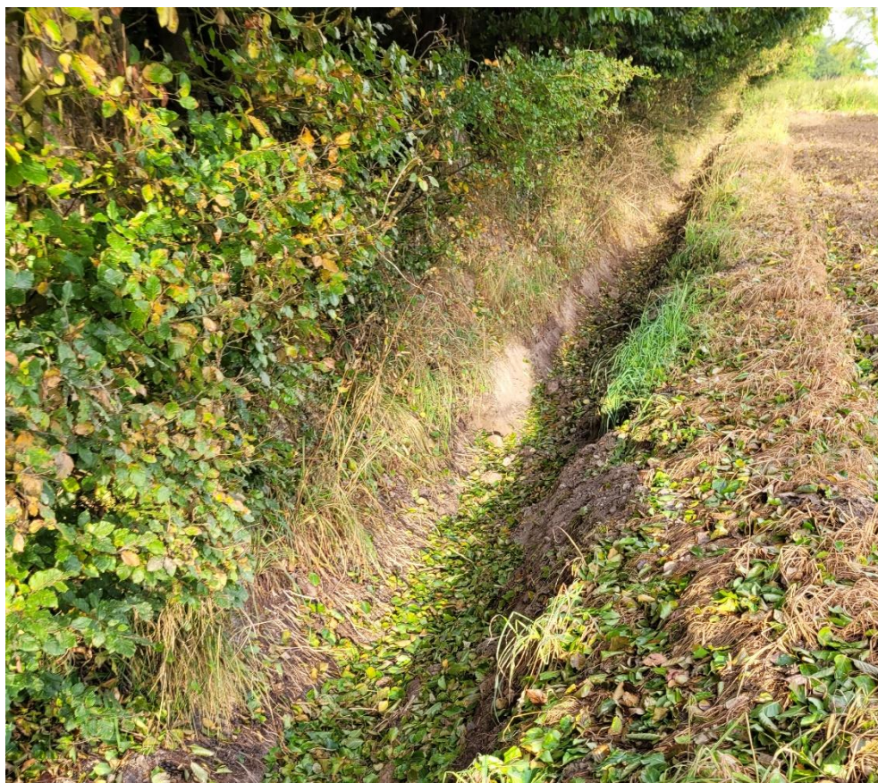
Figur 3: Kraftig udgravning af vandløbsbunden omkring st. -100 m.
